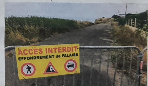
La commune est souvent confrontée à des éboulements de falaises. Augustin Thibouw
